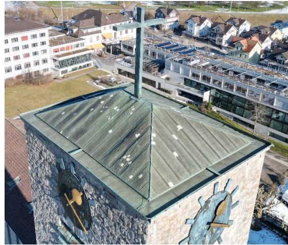
Bild: Dach Kirchturm mit zahlreichen reparierten Stellen (helle Flächen)
